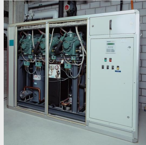
“Oberschule Heerbrugg“ Wärmequelle: Sonden Kälte-/Heizleistung: 95/130kW Kältemittel R134 A
