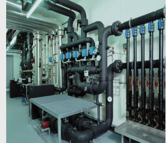
Wohngebäude „Dennlerstrasse“ Wärmequelle: Sonden Kälte-/Heizleistung: 205/291kW Kältemittel 407C
