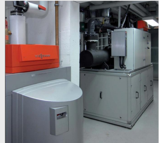
Wohnanlage Köln Kälte-/Heizleistung: 18/74kW Gas-Brennwertkessel 105kW
