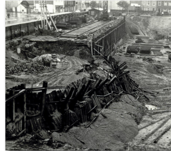
Karstadt-Baustelle Oktober 1966 Das Bild zeigt die weggebrochene Spundwand Oktober 1966. © Archiv der Sparkasse Iserlohn
