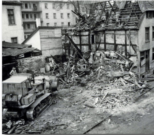
Abriss der Häuser in der Grabenstraße für den Neubau der Rhein-Ruhr-Bank 1954 © Archiv der Sparkasse Iserlohn
